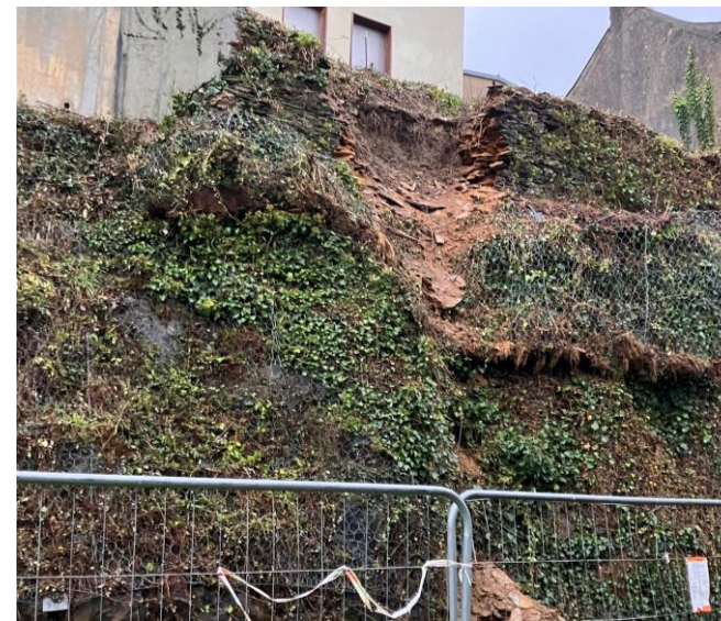
Éboulement de la tête du mur
