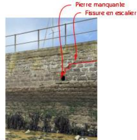
(3) Dégradation au niveau des pierres manquantes
