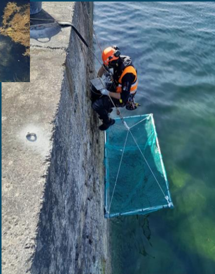
Filet de récupération des résidus de burinage
