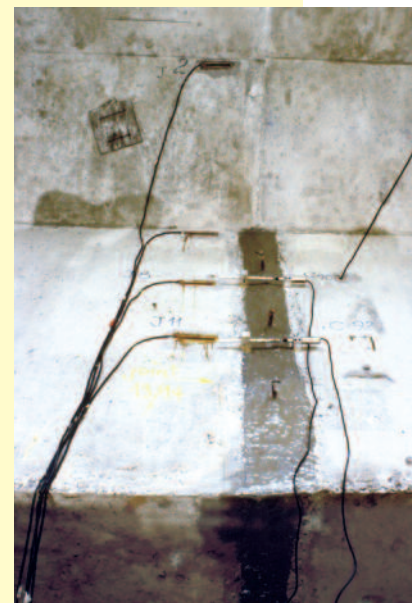
Photo n° 35 : implantation de jauges et de capteur pour contrôler une fissure active (crédit photo LRPC)
