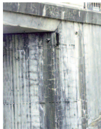
Photo n° 3 : fissuration due à une alcali-réaction du piédroit d'une culée (crédit photo Poineau)
