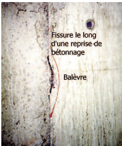
Photo n° 27 : fissure masquée localement par une balèvre (crédit photo Poinéau)
