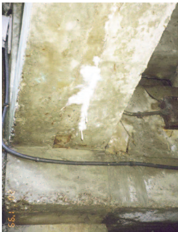
Photo n° 22 : dépôt de calcite le long d'une fissure (crédit photo Poineau)
