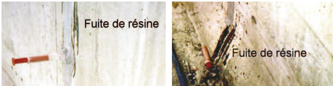
Photo n° 40 : fuites de résine d'injection (crédit photo Poineau)
