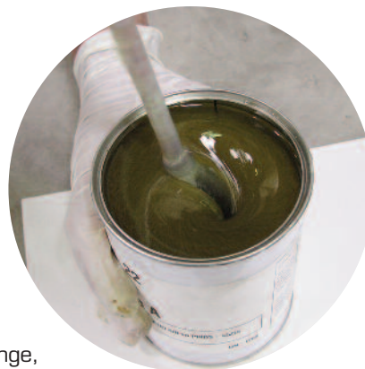
Photo n° 38 : mélange au malaxeur de la résine et du durcisseur (crédit photo Freyssinet)
