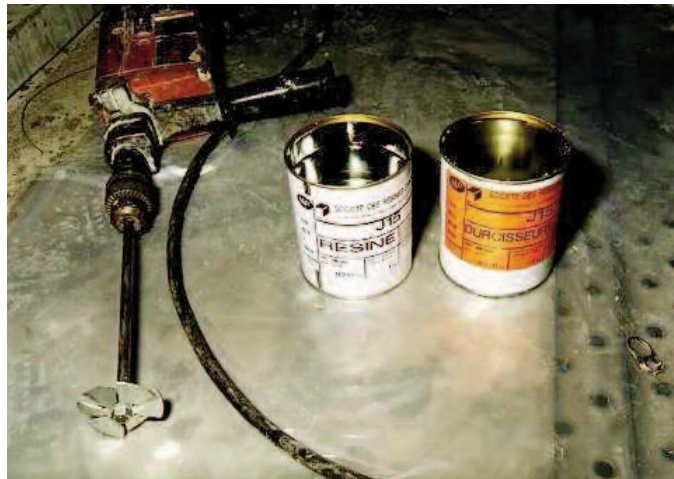
Photo n° 10 : étiquetage d'un pot de résine et d'un pot de durcisseur (crédit photo Sétra)
