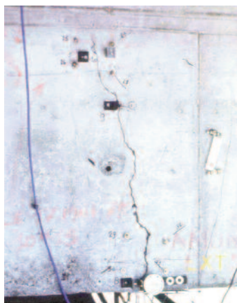
Photo n° 2 : fissure due à une insuffisance de résistance à la flexion d'une poutre en béton précontraint (crédit photo LRPC d'Aix-en-Provence)
