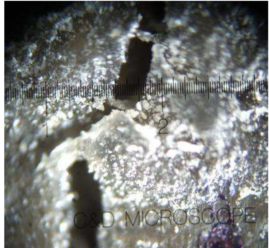
Fissure principale partiellement vidée
